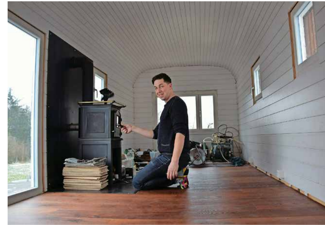
Kürzlich hat Kevin Rechsteiner Parkett in seinem Minihaus verlegt. Vor rund einem Jahr hat der 35-Jährige damit begonnen, den ehemaligen Zirkuswagen umzubauen. Im Frühling will er einziehen.
